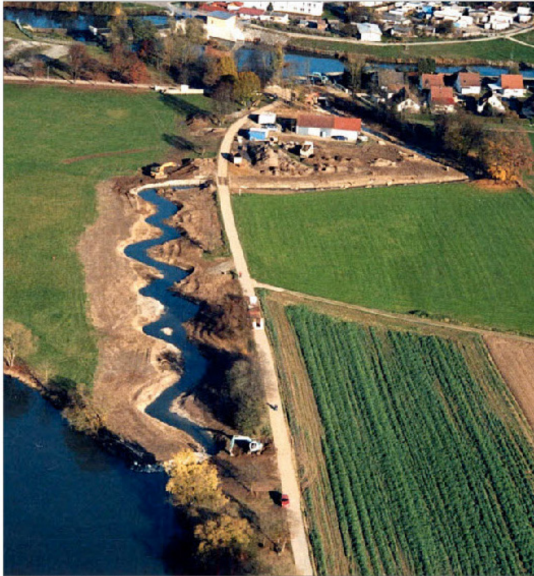
Als stattlicher Bach präsentiert sich das neu geschaffene Umgehungsgerinne an der Rott. – Foto: Kirk
