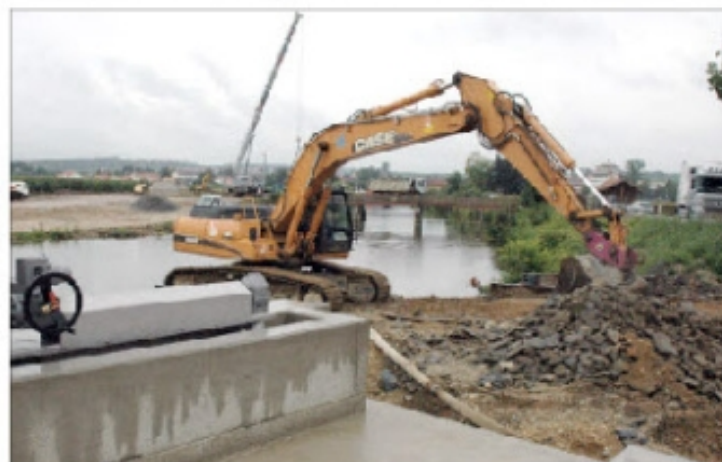
Bagger, Kran und Lkw im Dauereinsatz: Auf der Großbaustelle an der Rott geht es zurzeit mit Riesenschritten voran.
