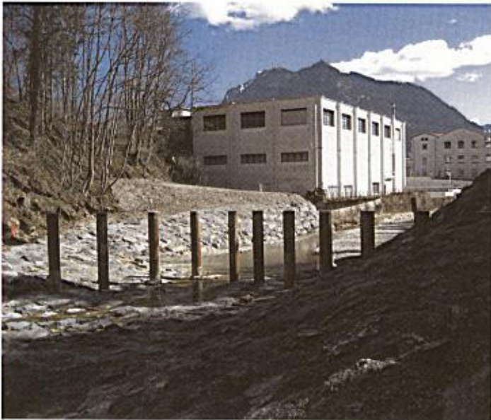
Über zehn Meter lang sind die Pfähle des massiven Wildholzrechens kurz vor dem Bosch Werk.
